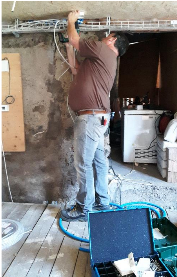
Installationen an der Kellerdecke.
