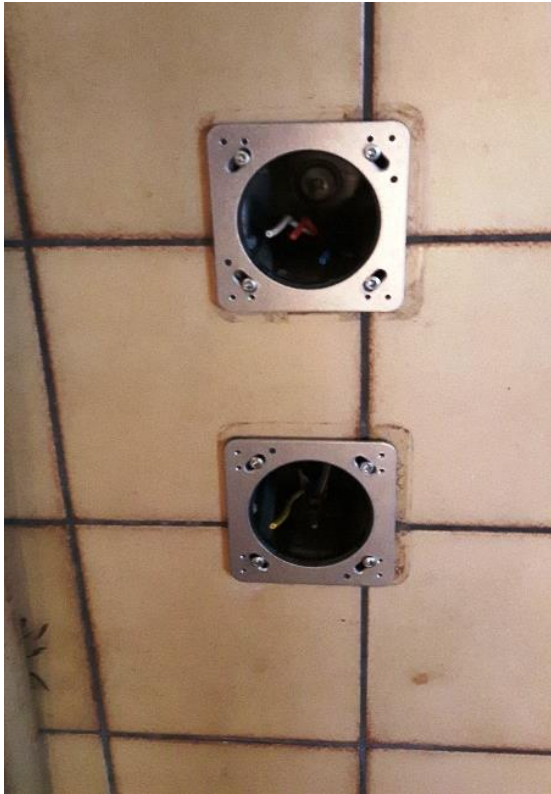
Zwei von vielen Schaltern, die ersetzt werden mussten.
