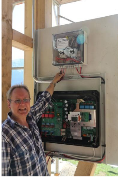
Ruedi Vosgerau von der Reich+Nievergelt AG erklärt die Funktionsweise der Solar Anlage
